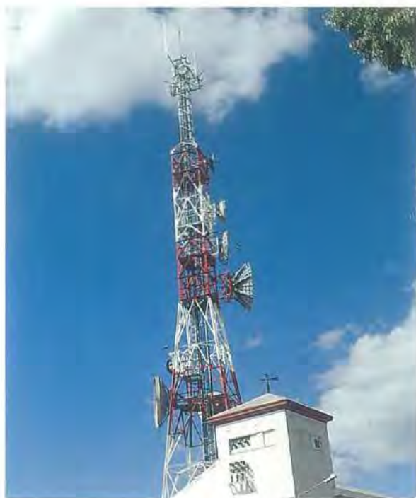
Repetidor de radio.
