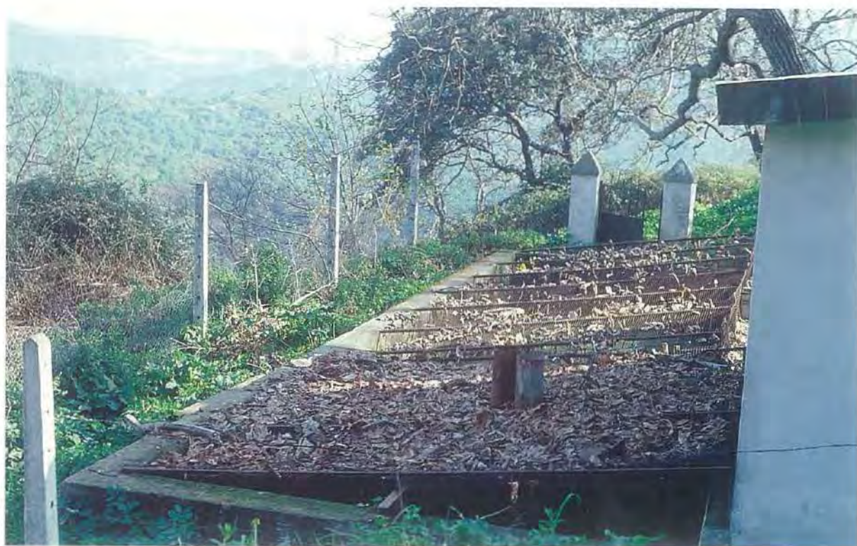
Depuradora fuera de servicio en Benalauria.
