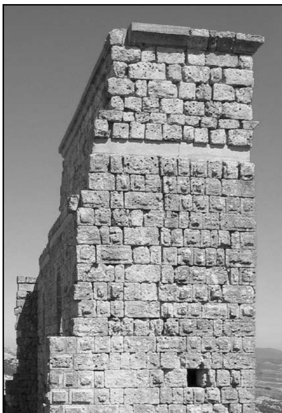
Fig. 5 Aspecto de las fisuraciones verticales formadas en los laterales de la escena del teatro
